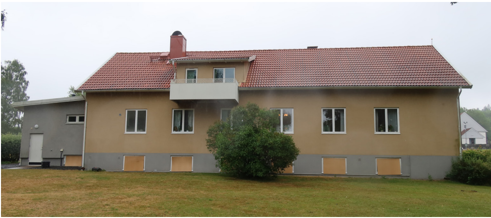
Fasaden mot gården. Bygglov för balkong gavs 1961. Vid fotograferingstillfället är skivor ställda som skydd för fönstren då gården används till lek.
